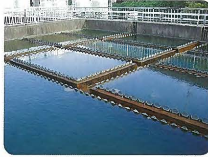
⑤ 最終沈殿池
