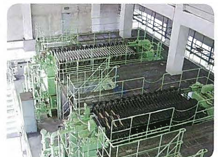
⑫ 汚泥脱水機
