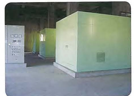
⑨機械濃縮機
