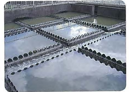
③最初沈殿池
