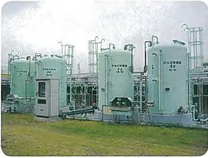
高度処理用PAC塔
