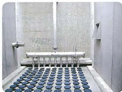
好気槽（散気装置）
